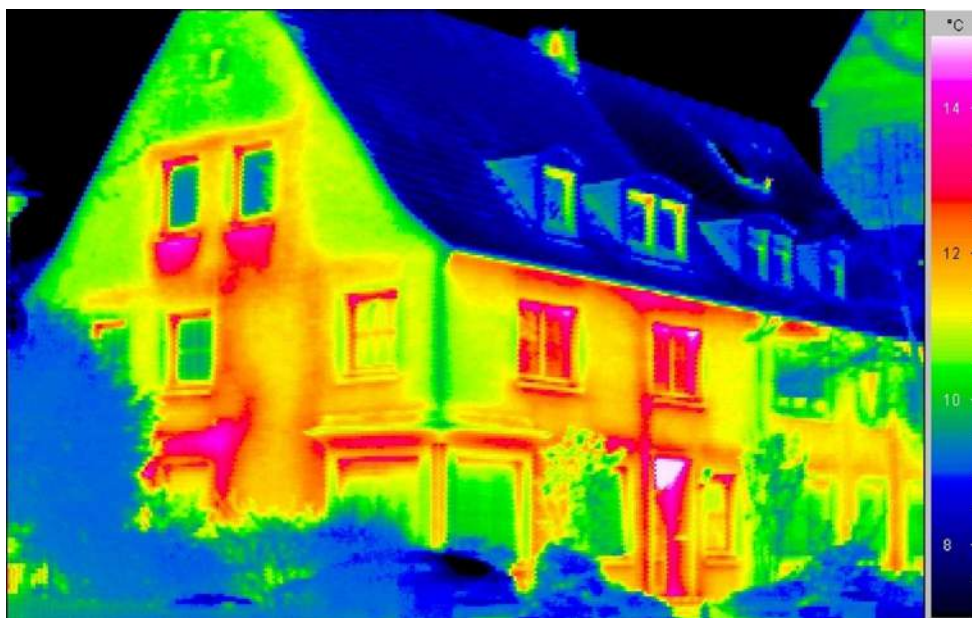
Abbildung 4.1: Wärmebild eines Gebäudes mit typischen Wärmebrücken wie schlecht abgedichteten Rolladenkästen, Heizkörpernischen sowie Fehler in der Außendämmung der Wände. [Bundesverband Deutscher Baustoff-Fachhandel e. V. (2008)]
